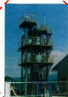
ジャパンブルーエナジーが開発し、宮古市で実証している水素貯蔵タンク。
